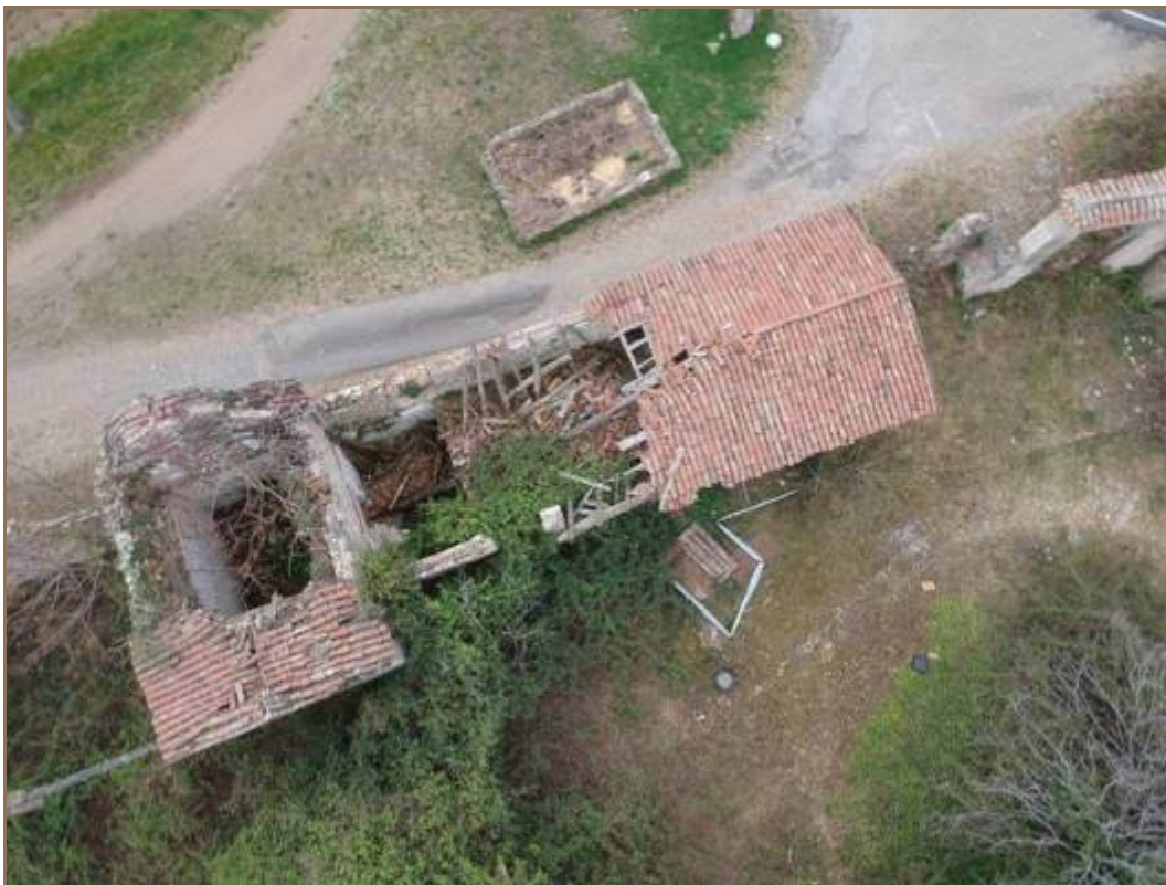
Si noti l'edificio invaso da vegetazione e gli evidenti crolli delle coperture in tutta la porzione est del complesso
